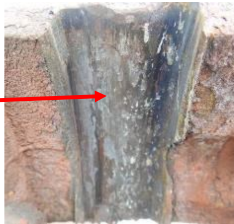
Ft. 32 Tragovi struganja i termičkih oštećenja čeljusti
